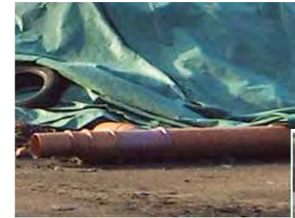
Ursprüngliche On floor-Belüftung mit Kunststoffrohre
