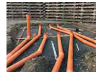
Verbindungsleitungen zu Ventilatoren und Siphonschacht
